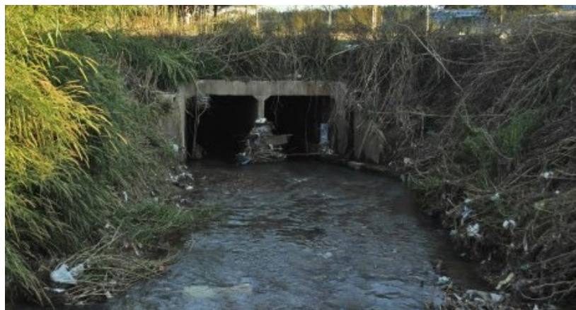
Fotografia 4. Degradação do Arroio da Ronda Fonte: Foca Foto UEPG (2015).
