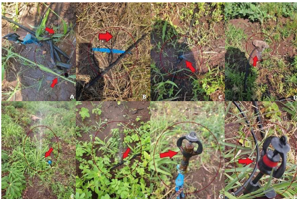
A – Vazamento no final de linha em decorrência de fechamento inadequado; B – Não substituição de emissor na área de cultivo, efetuando simplesmente o interrompimento de água no microtubo; C – Vazamento em registro de linha com defeito; D – Vazamento em linha lateral encoberto com pedras; E – Vazamento em linha lateral na conexão no microtubo do microaspersor; F – Vazamento decorrente de corte na linha lateral; G – Entupimento total do microaspersor com causas de fácil visualização; H – Entupimento total do microaspersor sem causas de fácil visualização.
