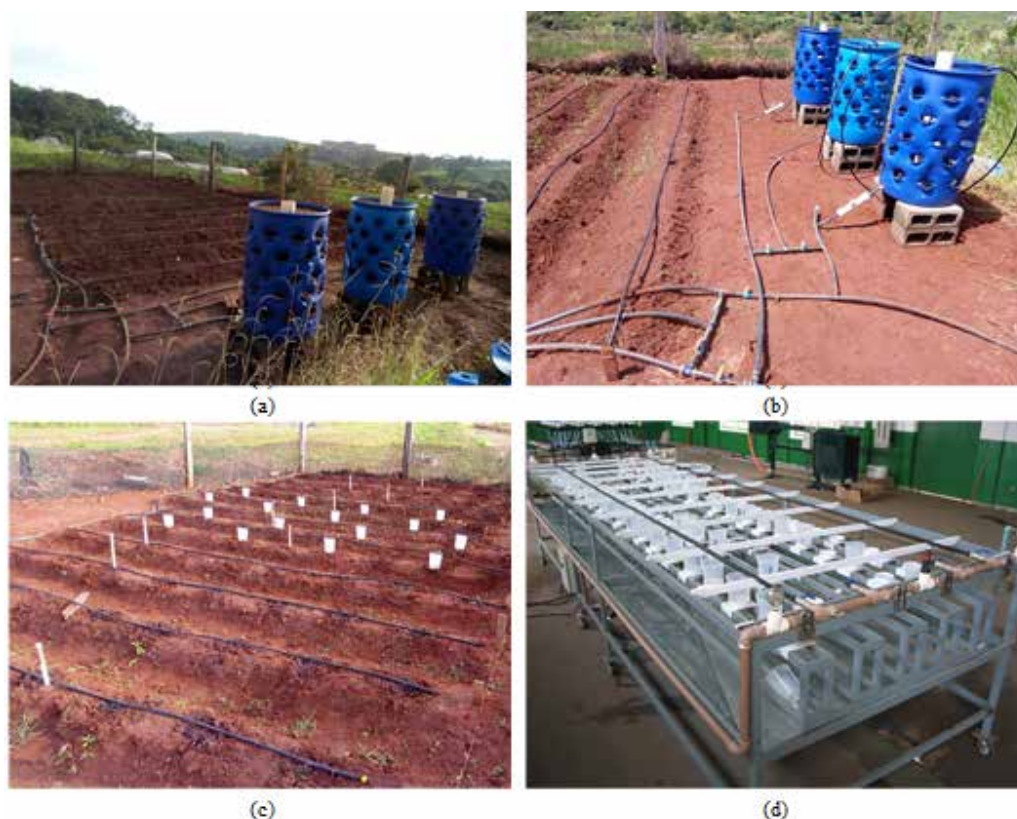
Figura 2. Vista geral da área experimental e coleta de amostras de vazão no campo e na bancada Vista geral da unidade experimental (a); instalação das linhas de gotejo no sistema de cultivo vertical (b); coleta de amostras da vazão dos gotejadores do sistema de cultivo convencional (c); e vertical (d) na banca do Laboratório de Irrigação. Fonte: Fotos Valdemiro Pitoro, 2018).
